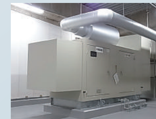
非常用電源設備
