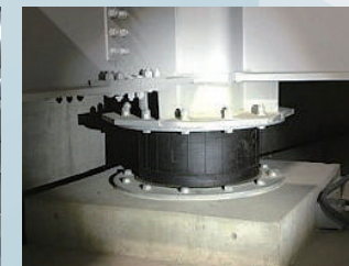
フロア下に設置された防震ダンパー
